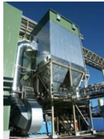
Kammerfilter zur Rauchgasreinigung
