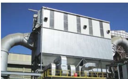
Камерный фильтр в цементной промышленности
