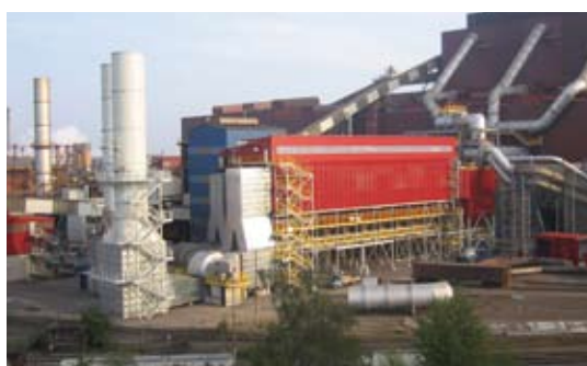
Камерный фильтр в сталелитейной промышленности
