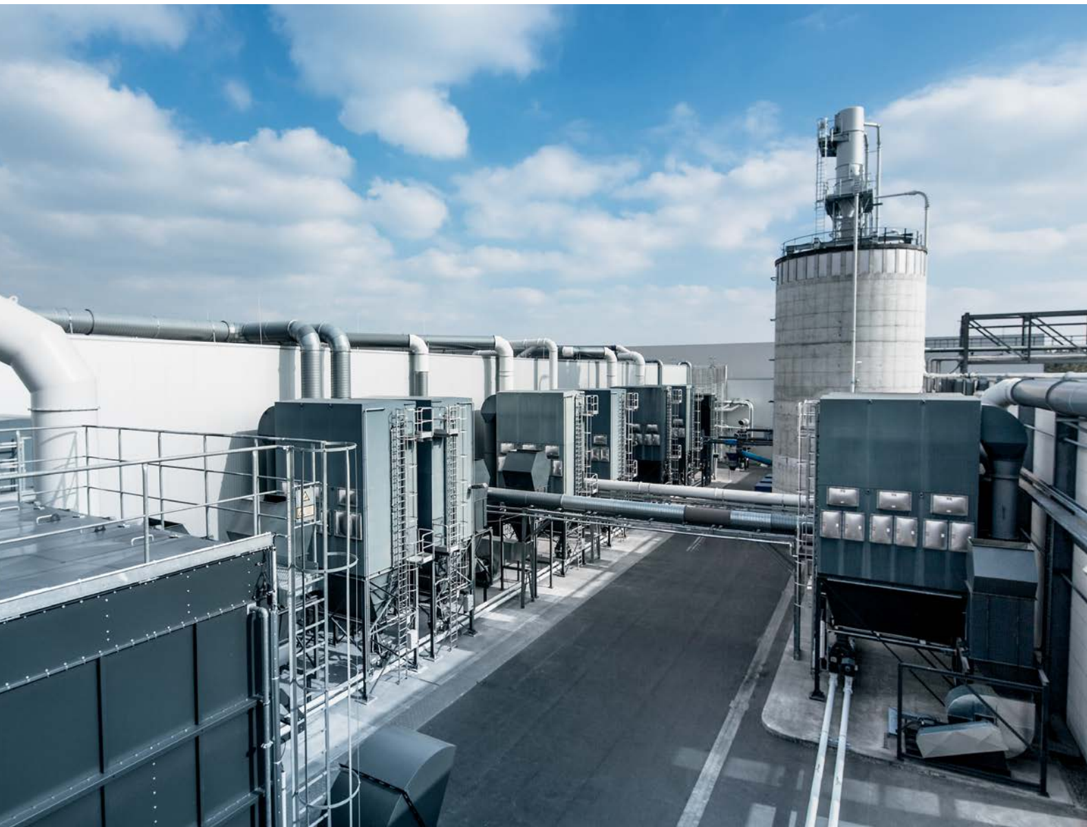
Filterinnenhof von Werk 1 und 2 mit den beiden Hochdruckförderrohrleitungen.
