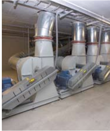
Förderventilatoren für eine Gruppenabsaugung
