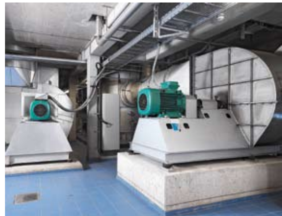
Ventilatoren mit Kupplungsantrieb
